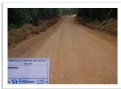
Kondisi Jalan Miri – Batu Tangkui
