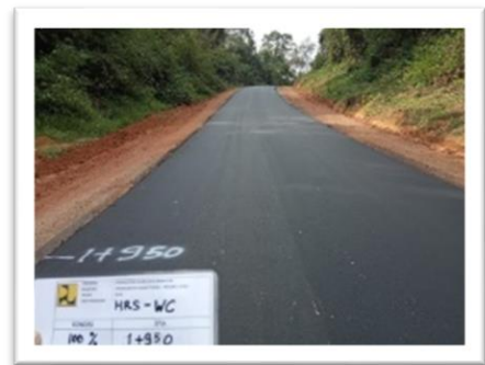
Kondisi Jalan Tukau - Tehang
